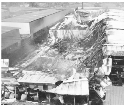
图 6-2 钢结构受火烧后垮塌
