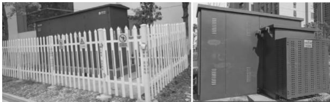
图 1-10 带有护栏的环网柜和带有外罩的箱式变压器
